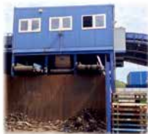
Be- & Entlüftung von Sortierkabinen
