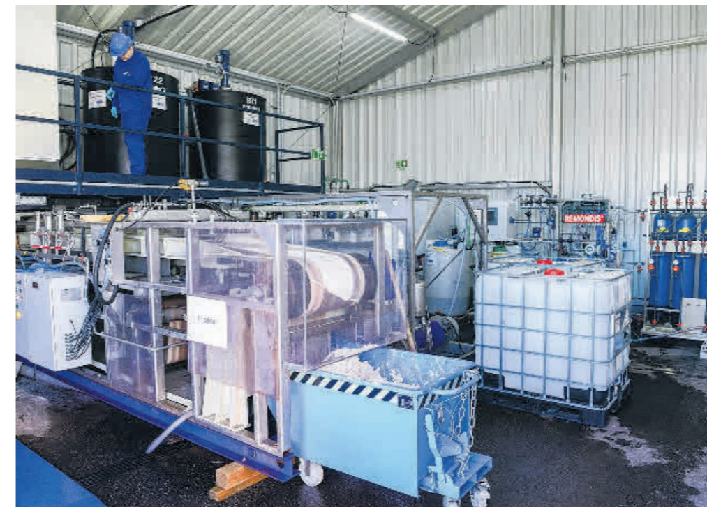
Die Pilotanlage: Hier erprobte das Recyclingunternehmen Remondis das Verfahren zur Gewinnung von Phosphorsäure aus der Asche des verbrannten Klärschlammes. Foto: Jörg Böthling
